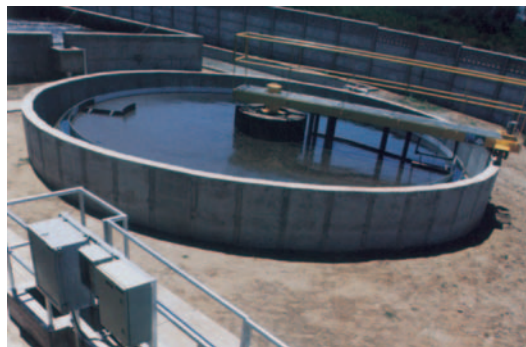
Planta de Tratamiento de Aguas Servidas.
